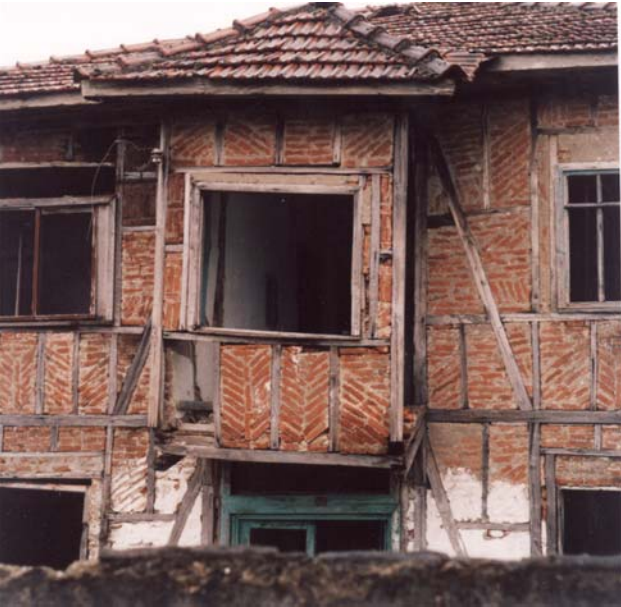
Şekil 25. Cumbada hasar, Düzce
