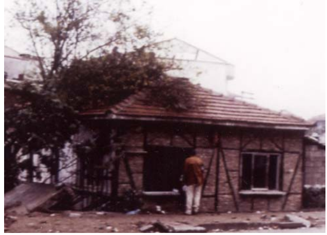
Şekil 19. Arazideki sıvılaşmanın yapının temelinde oturma meydana getirmesi, Adapazarı
