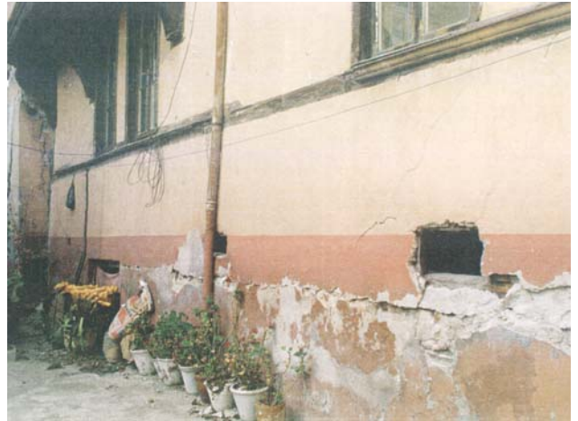
Şekil 23. Kargir zemin kat duvarında çatlaklar meydana gelmesi, Adapazarı
