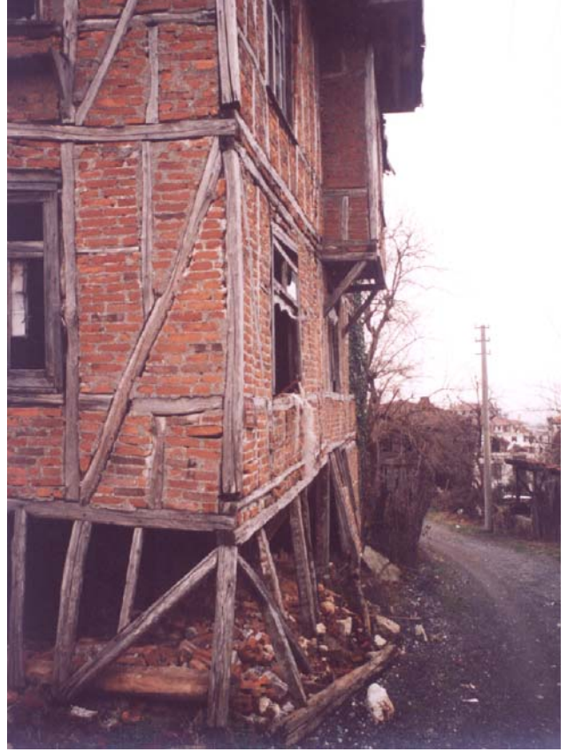
Şekil 22. Hımiş yapıda dolgunun yıkılarak ahşap elemanlara zarar vermesi, Akçakoca
