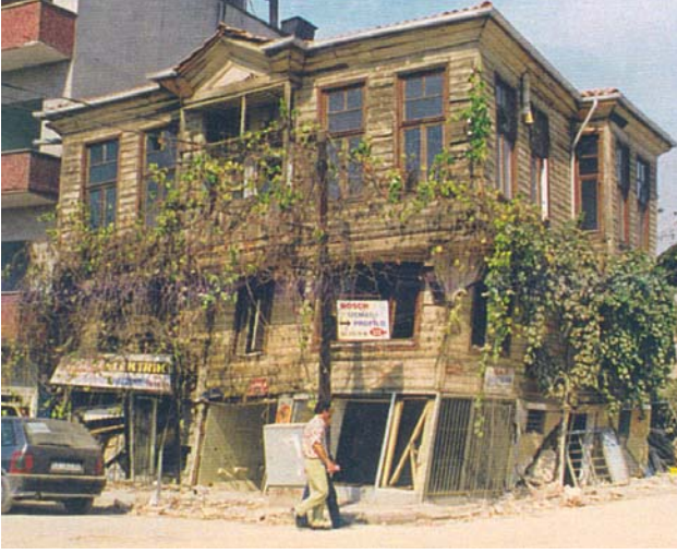
Şekil 21 Yapıda yanıl ötelenmeler meydana gelmesi (Bursa Koruma Kurulu Arşivi)
