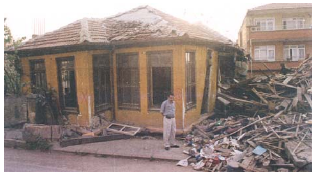
Şekil 20. Zemin katın yıkılması, Adapazarı (Bursa Koruma Kurulu Arşivi)
