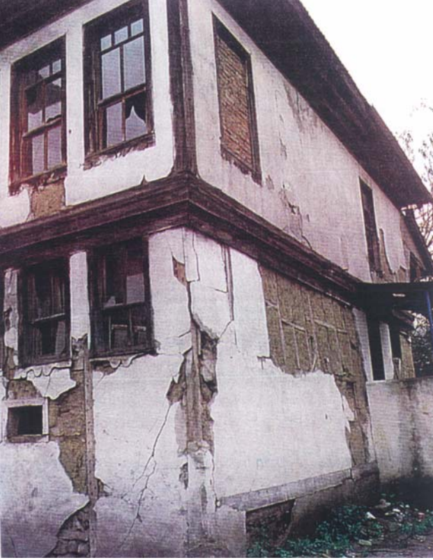
Şekil 24. Hımsız yapıda dolgu dökülmesi, Sapanca (Bursa Koruma Kurulu Arşivi)
